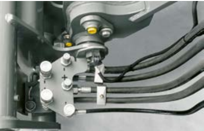
Hydrauliekaansluitingen veilig aangebracht op het snelwisselbord.
